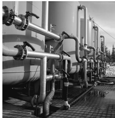
Fig. 4 Tratamiento de agua
